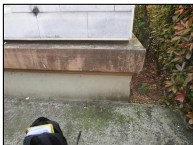
Photo N° 76 ECH-N°7 -1R+1 - Bat.4 Calmette Façade Murs bas - soubassements Enduit + peinture
