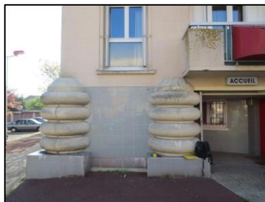
Photo N° 2 ECH-N°1 -1R+8 - BAT.13 Façade - Murs Colle faïence grise
