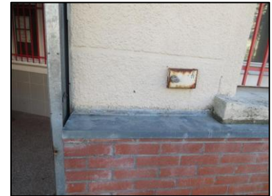
Photo N° 12 ECH-N°5 -1R+8-BAT.13 Façade Bavette mur brique rouge Mastic
