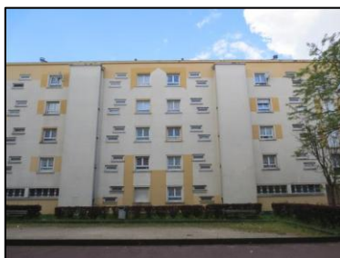
Photo N° 70 ECH-N°40 -1R+4 - Esc.8-9 J.SIEG. Façades Murs Mortier + peinture
