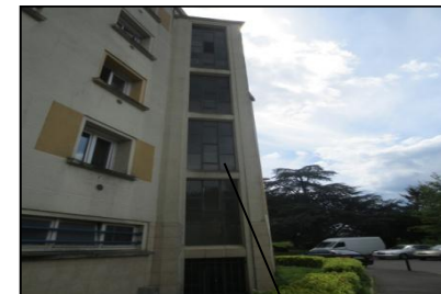
ECH-N°35 -1R+4-Esc5-6J.SIEG.Baie vitrée esc/Baies vitrées Mastic, (photo n° 91)
