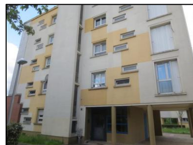
Photo N° 72 ECH-N°41 -1R+4-Esc. 10 J.SIEG. Façades Murs Mortier + peinture
