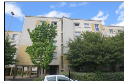
ECH-N°28 -1R+4-Esc.1J.SIEG.-Façades/Murs Mortier + peinture, (photo n° 87)
