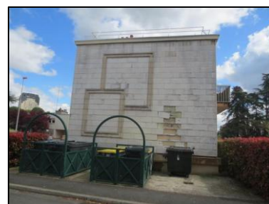
Photo N° 46 ECH-N°6 -1R+1-Bat.4 Calmette Pignon Murs Colle + dalles
