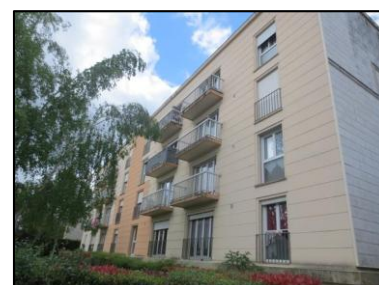
Photo N° 42 ECH-N°26 -1R+3 - Esc11-12 Ribot Façades Murs Mortier + peinture
