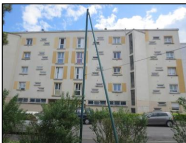
Photo N° 62 ECH-N°34 -1R+4 - Esc.5-6J.SIEG. Façades Murs Mortier + peinture
