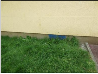
Photo N° 93 ECH-N°39 -1R+4 - Esc.8-9 J.SIEG. Façades Murs bas - soubassement Mortier + peinture
