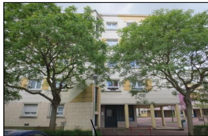
ECH-N°31 -1R+4-Esc.4 J. SIEG.- Façades/Murs Mortier + peinture, (photo n° 56)
