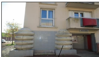
ECH-N°4/13--1R+8-BAT.13 - Façade/Moultures Enduit + peinture, (photo n° 5)
