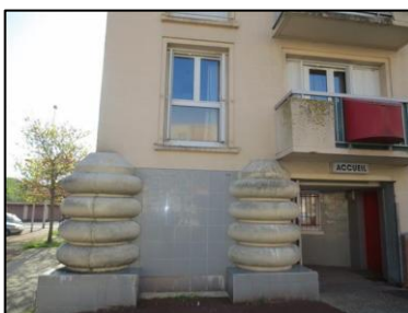
Photo N° 5 ECH-N°4 -1R+8 - BAT.13 Façade Moultures Enduit + peinture
