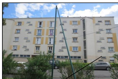
ECH-N°34 -1R+4-Esc.5-6J.SIEG.-Façades/Murs Mortier + peinture, (photo n° 62)
